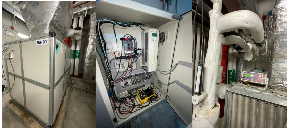
รูปที่ 4-7 การติดตั้งเครื่องวัดในเครื่องจ่ายลมเย็น AHU5
